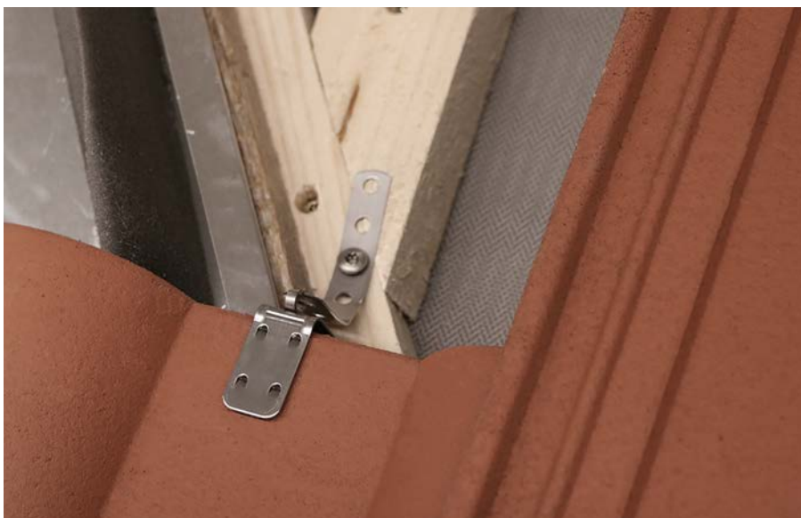
Die 512-100 ist geeignet für die mechanische Sicherung geschnittener Stücke in der Kehle nach dem Regelwerk des Deutschen Dachdeckerhandwerks
